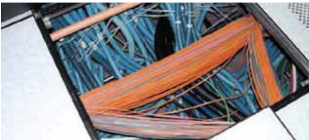
[그림2] 전산실 바닥 하부의 Cable 배전 System
