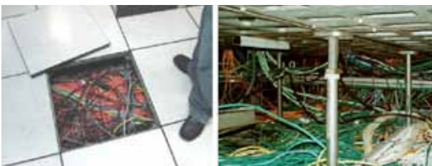
[그림 3] 실제 Data Center의 Cable 배선 현황
